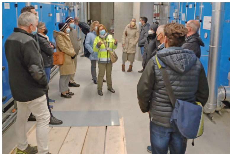
Im «Bauch» des Gebäudekomplexes – hier wird eingheizt.
