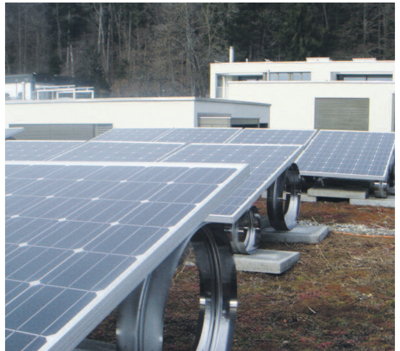
Die Photovoltaikanlage der Familie Rüber Arrigoni wurde mit einem materialsparenden Montagesystem installiert. (Firma LEC)
