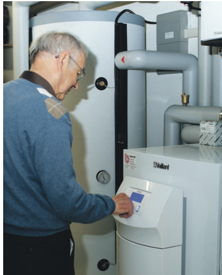
Eingestellt für umweltfreundliche Energie: Christian Kim bedient die neue Erdwärme-Heizung. (Energiestadt Künsnacht)
