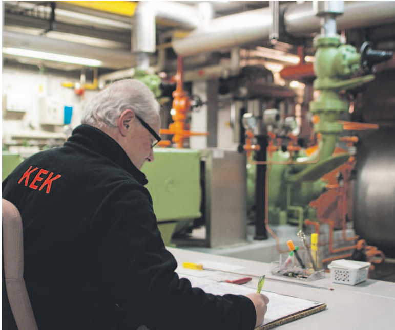
Betriebsleiter Hansruedi Rütimann an der Arbeit im Kompressorenraum der KEK. (Energistadt Küssnacht)
